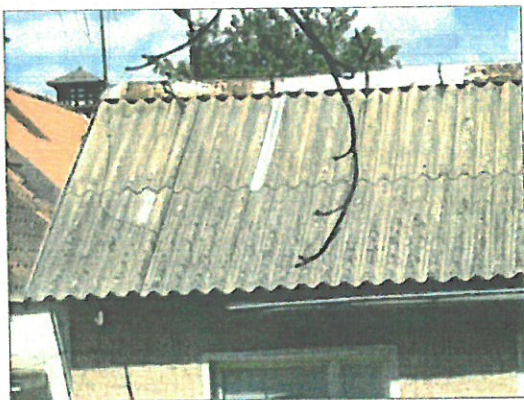
Fot. 1 Płyty azbestowo-cementowe faliste
