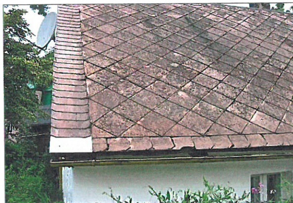
Fot. 2 Płyty azbestowo-cementowe płaskie
