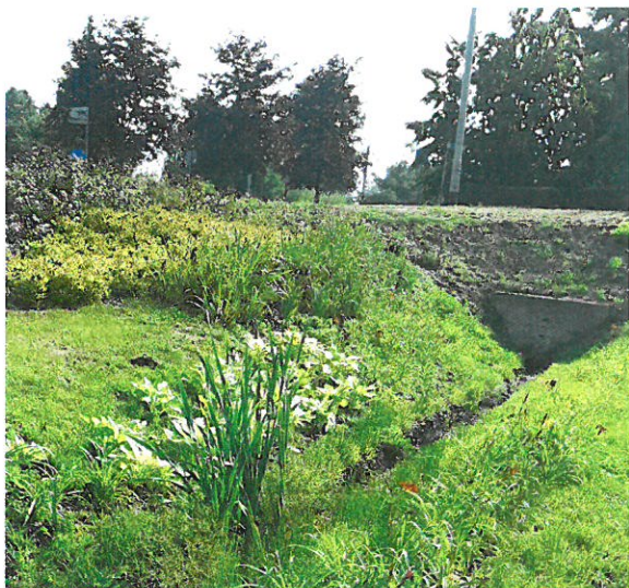
fot. widok skarpy przed umocnieniem
