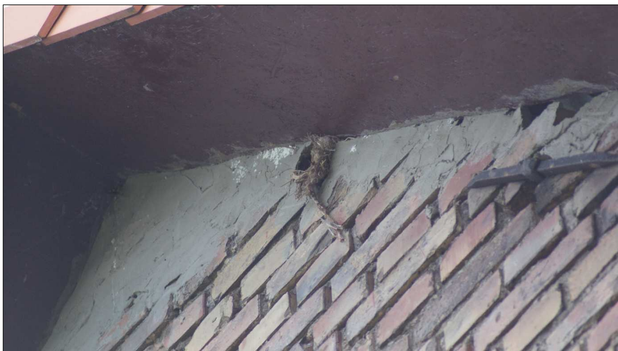
Fot. 4. Gniazdo wróbli w ubytku w murze na północno-wschodniej (szczytowej) ścianie budynku (nr 2).
