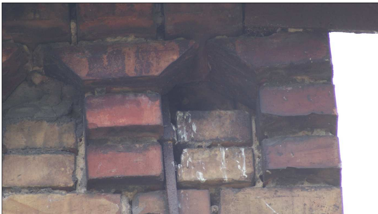
Fot. 5. Gniazdo wróbli w ubytku w murze na tylnej ścianie budynku (nr 3).
