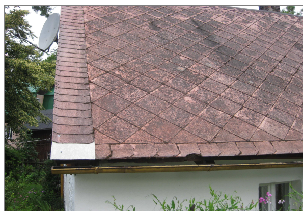
Fot. 2 Płyty azbestowo-cementowe płaskie
