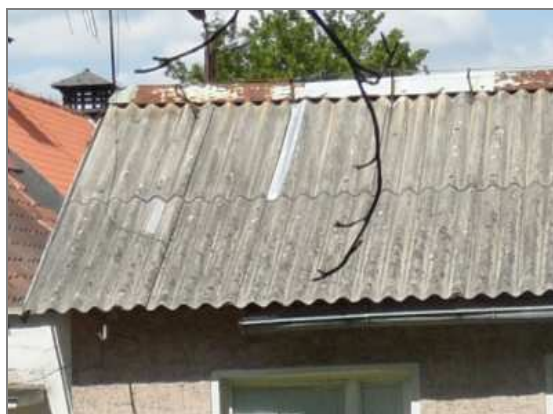
Fot.1 Płyty azbestowo-cementowe faliste
