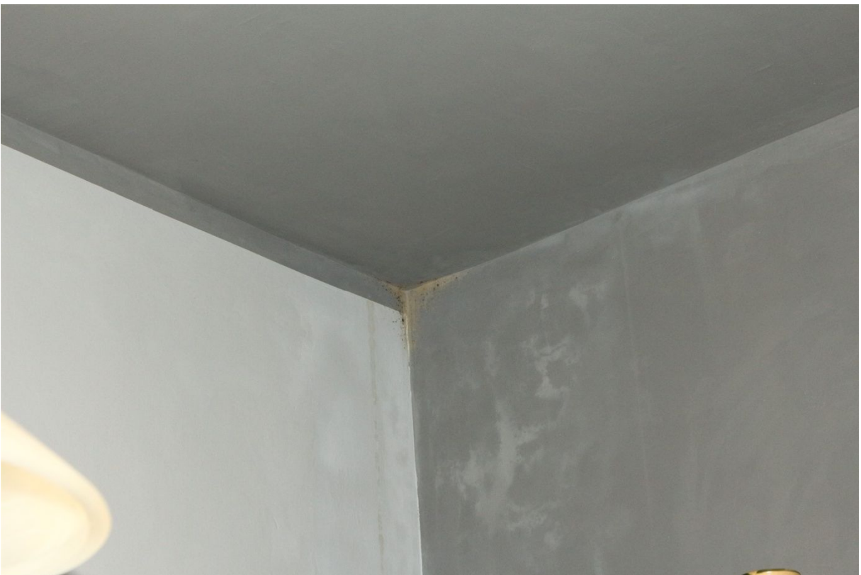
Widoczne ślady przemarzania - ściana szczytowa
