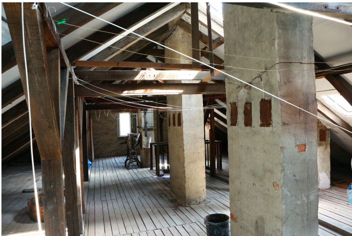
Stan więzby dachowej - strych budynku głównego
