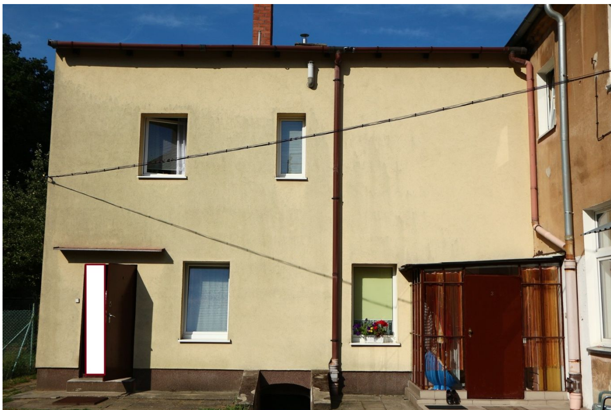
Elewacja wsch - część dobudowana ocieplona oraz widoczny stan techniczny rur spustowych budynku głównego
