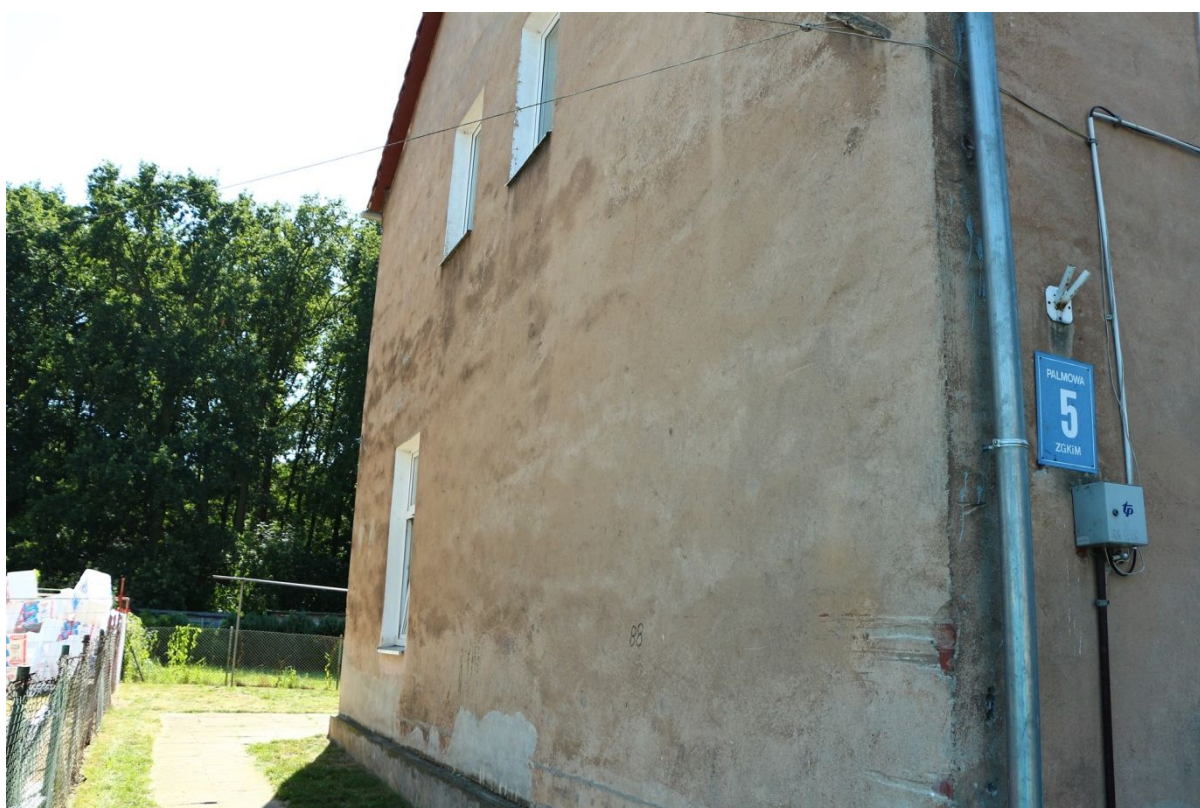
Widoczne na ścianie ślady zacieków i przemarzania tynku.
