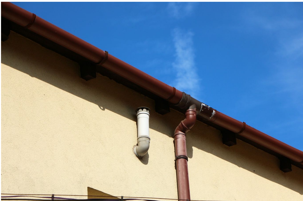
Wywiewka kanalizacyjna oraz rura spustowa do przełożenia
