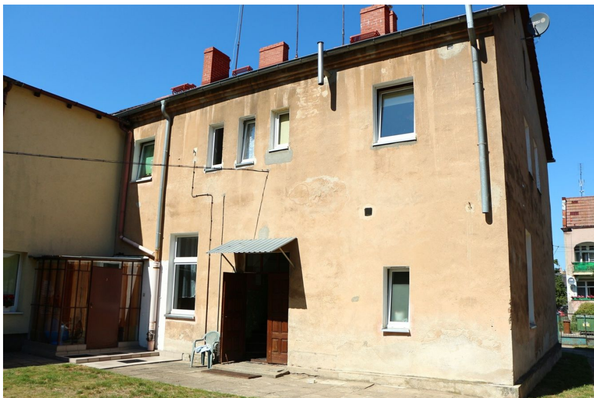
Elewacja pd - ściana tylna budynku Palmowa nr 5, ślady po wykwitach w części gzymsowej oraz w innych obszarach
