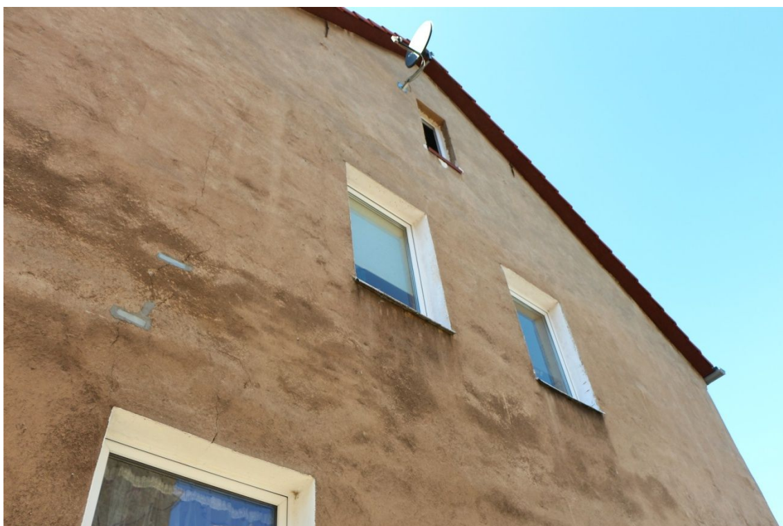
Ściana szczytowa - zarysowanie ściany , założone szkło kontrolne
