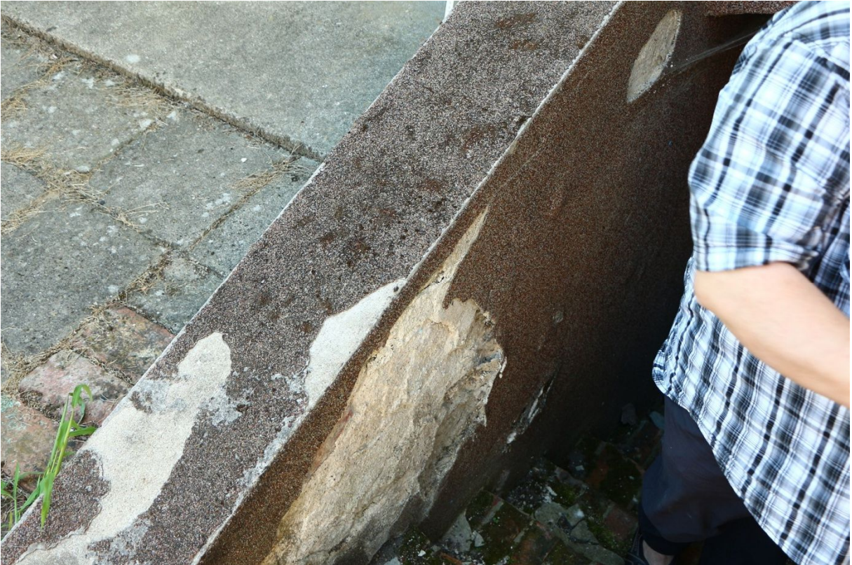
Zawilgocenie - wejście do piwnicy
