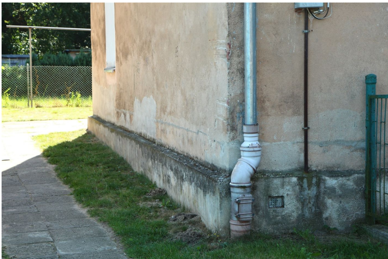
Cokół betonowy - nad cokołem uszkodzenia tynku
