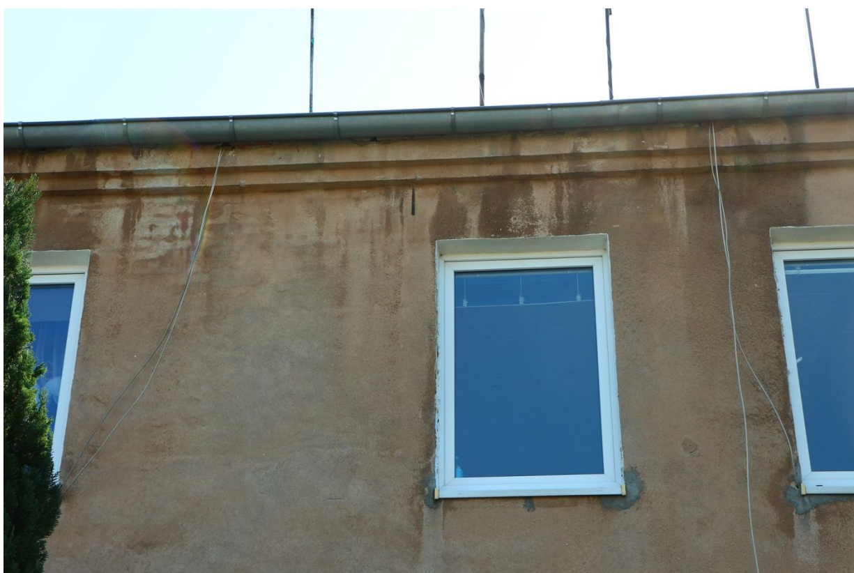
Ślady zacieków i zawilgocenia części gzymsowej
