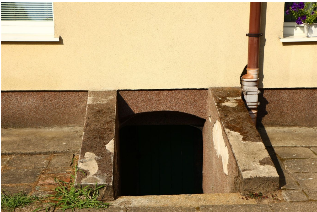
Ślady zawilgocenia - wejście do piwnicy pod częścią ocieplaną
